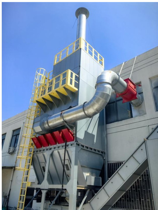
半成品车间木加工粉尘废气处理设施 DA001
