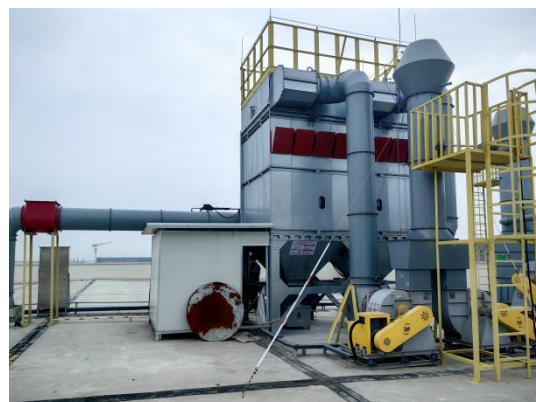
成品车间木加工废气处理设施 DA007
