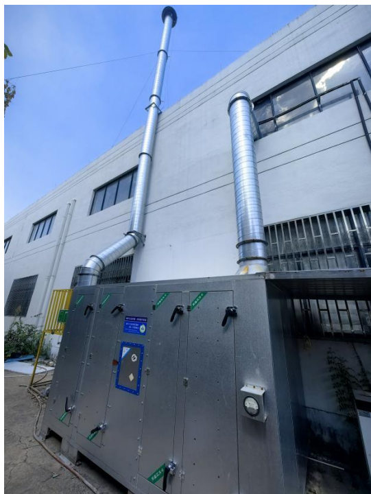
涂泥烘干废气、PVC 挤塑废气处理设施 DA003
