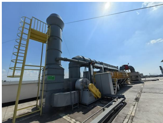
北侧两间喷房内喷漆废气（含面漆调配、喷漆、喷枪清洗废气）、危废仓库废气处理设施 DA012
