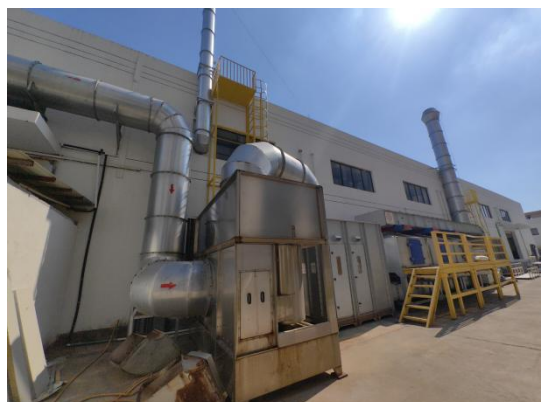
底漆打磨废气经侧方集气+干式过滤系统处理设施 DA006
