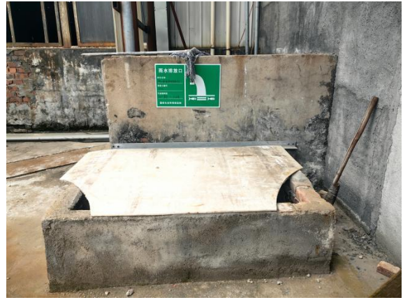
厂区雨水排放口
