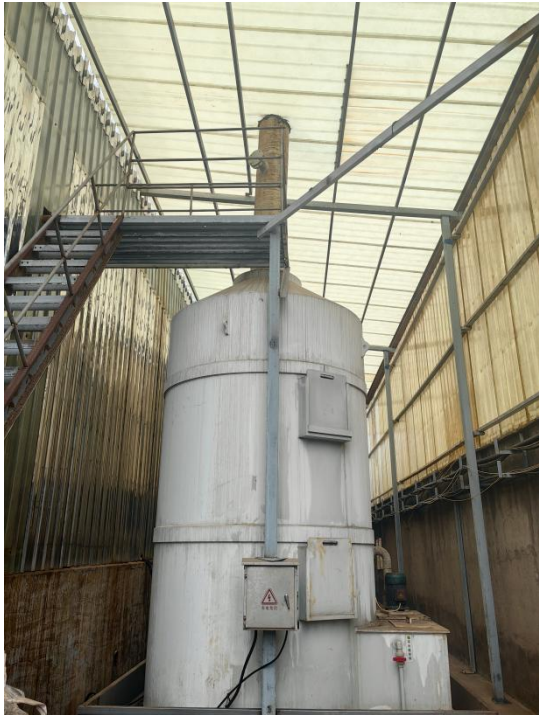
酸洗废气处理设施（四级碱喷淋）
