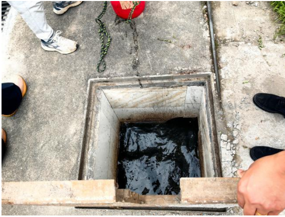
厂区污水收集池
