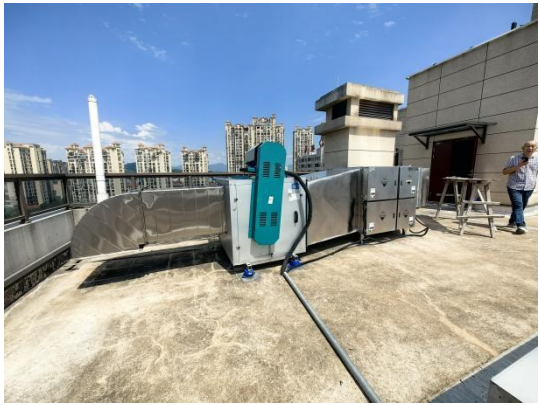
油烟净化设施排放口
