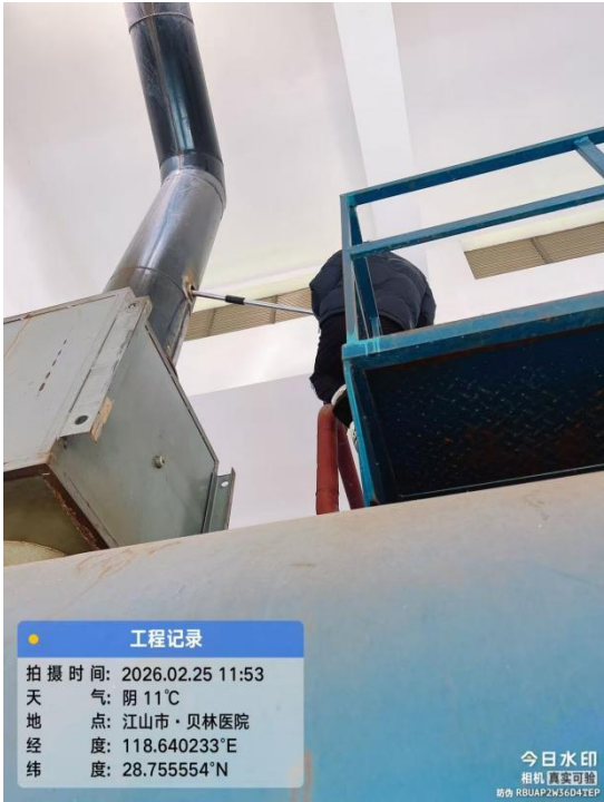
锅炉废气排放口
